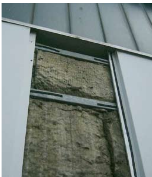
Na 25 jaar is de dragende achterconstructie, dankzij de duurzame zinklaag, nog in prima conditie.
